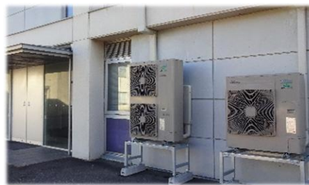
管理棟に設置されたエアコンの室外機
