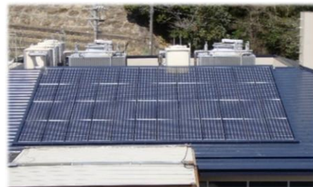
実験棟の屋根に設置された太陽光パネル
