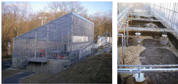
排水処理施設（北海道区水産研究所鶴居さけます事業所）
