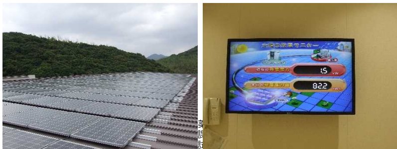
水産大学校多目的学生教育棟に設置された太陽光発電パネル（左）及び発電状況を表示するパネル（右）
