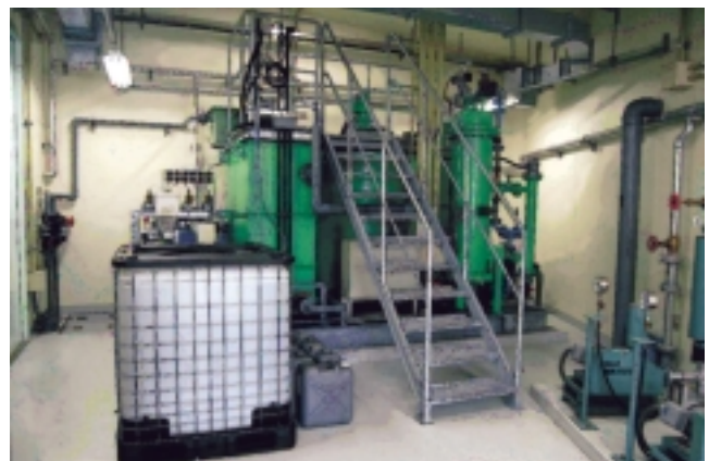
写真2 排水処理設備
