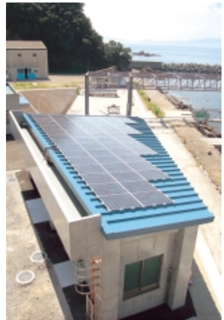
写真3 排水処理施設の太陽光発電設備の発電パネル
