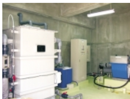
八重山排水処理設備
