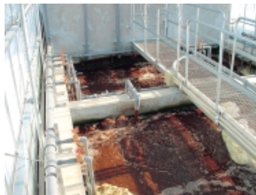
微生物を利用した排水浄化システム
