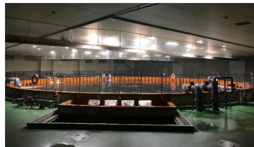
図1. 水温と日照時間の環境制御が可能な大型陸上水槽（直径20m、深さ6m、容積1,880m 3 ）
