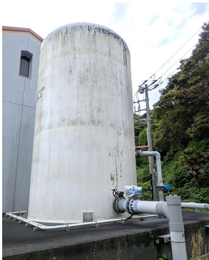
(2) 屋外海水ろ過機No.3 側面外観
