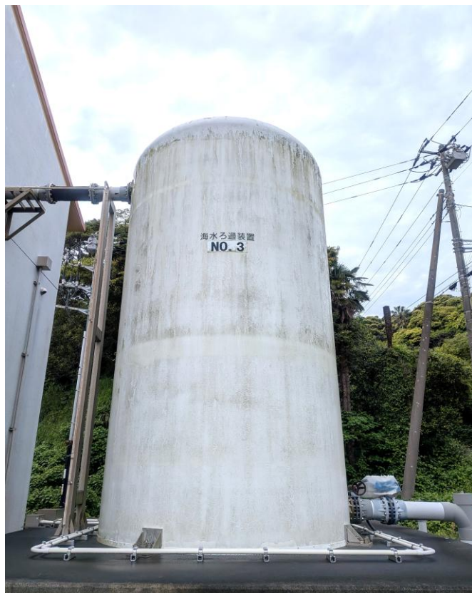
(1) 屋外海水ろ過機No.3 正面外観
