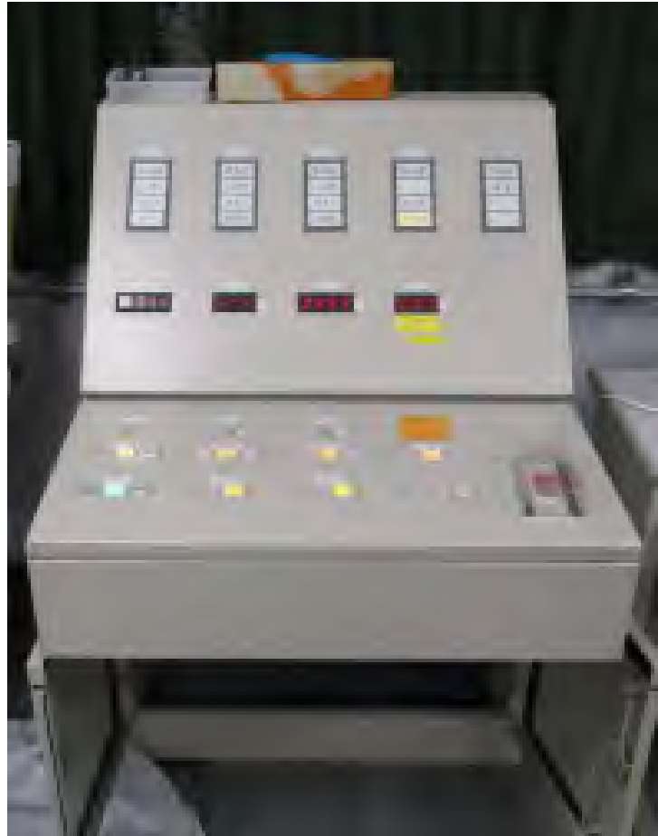
図8 使用中の制御処理室の制御盤
