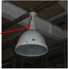
照明機器の塩害
